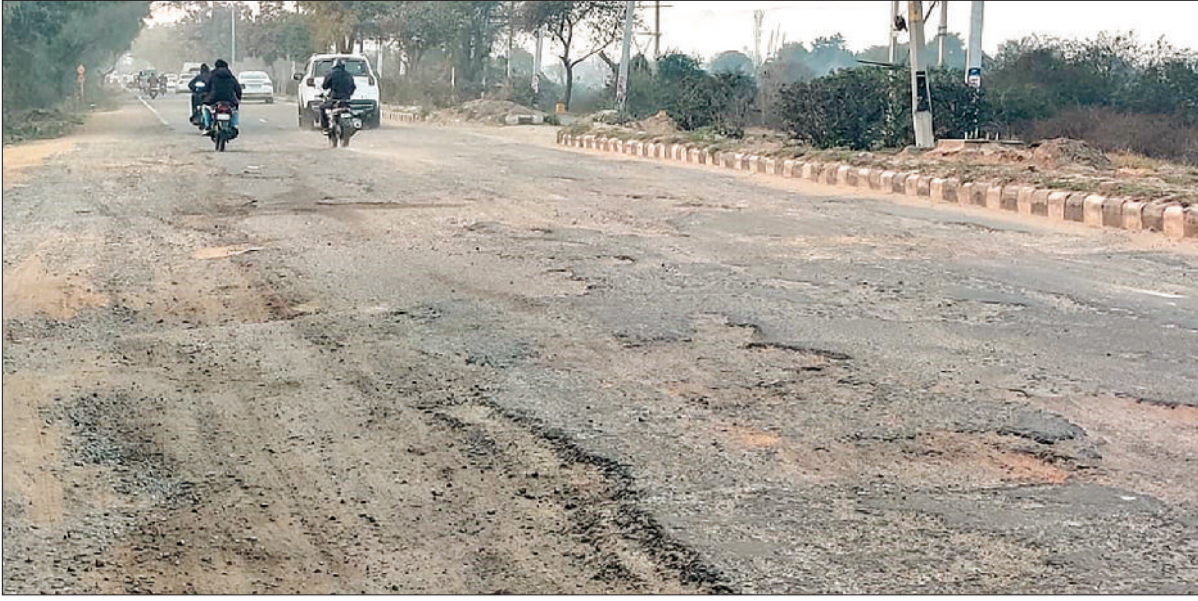
वीटा प्लांट से नया बस अड्डा तक की सड़क की हालत जर्जर
